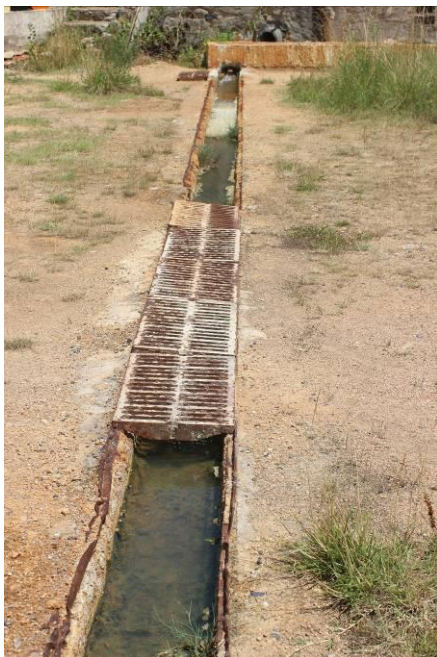
Arrivée du trop-plein de l’usine permettant d’alimenter la zone d’épanchement, ©CEN, SC
