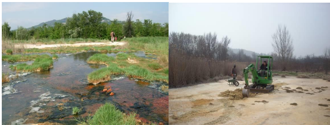
La même zone en 2008 et en 2015 après déviation naturelle des écoulements suite à la pétrification. Travaux en 2015 pour refaire circuler l’eau dans cette zone, sans succès, ©CEN, SE
